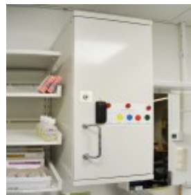
Huumekaappi sähkölukolla ja kulunvalvonnalla
